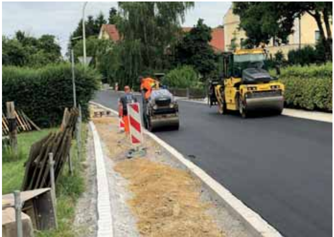
Die Arbeiten in der Ortsdurchfahrt Thann schreiten voran, aktuell finden Asphaltierungsarbeiten statt. Foto: Staatliches Bauamt Landshut
