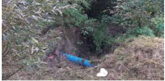
Abgeschwemmte Dammwand beim Regenrückhaltebecken Metzgerfeld
